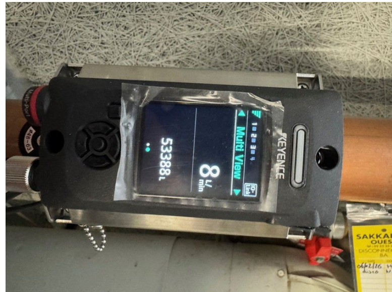
Débitmètre Keyence FD-H63, même conduite
