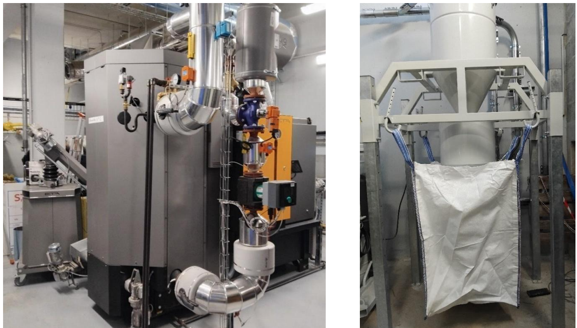
Figure 7 : Exemple d'une chaufferie équipée d'un cendrier à roulette (gauche) avec transfert par vis sans fin dans le cendrier puis aspiration jusque dans un big-bag (droite) (Réseau de chaleur de Quiberon)
