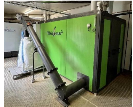
Figure 4 : Exemple d'évacuation des cendres par vis sans fin (crédits : Heizomat)
