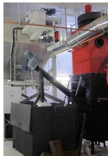
Figure 9 : Exemple d'un big-bag refermable (Réseau de Chaleur de Combourg)
