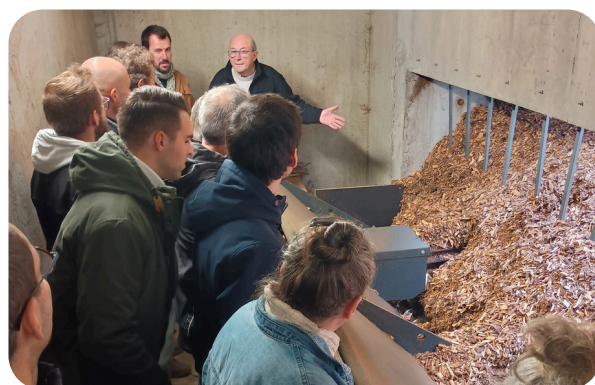
Visite de la chaufferie bois de Bourbriac, 2024
